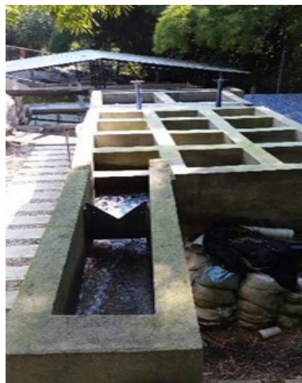
Figura 8. Canaleta Parshall y Floculador Tipo Alabama
