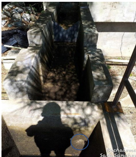
Figura 17. Ingreso de Agua a la Primera Cámara del Floculador
