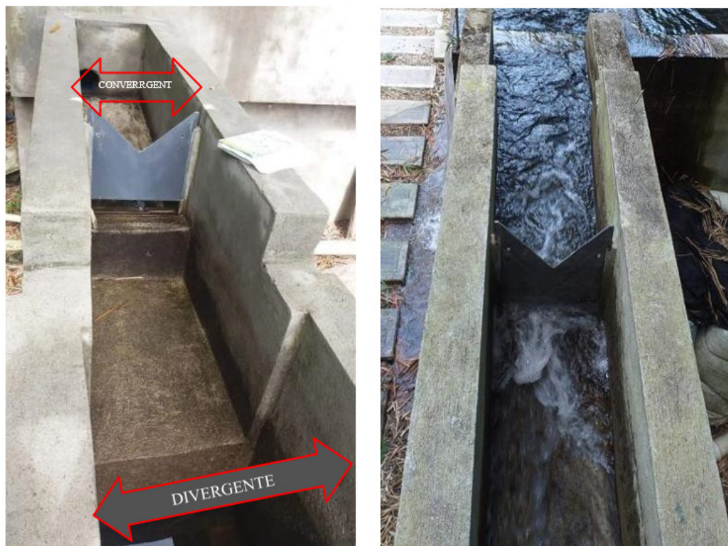
Figura 6. Tubería de Ingreso y Canaleta Parshall
