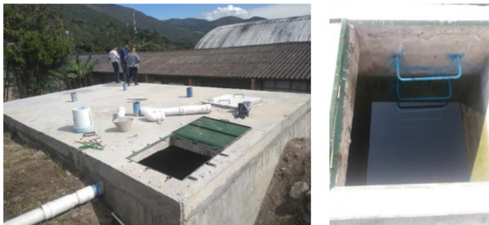
Figura 15. Tanque de Almacenamiento Nuevo
